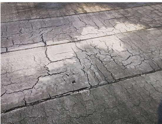
東小学校 校舎-3(③棟) C評価 露出防水が劣化している
