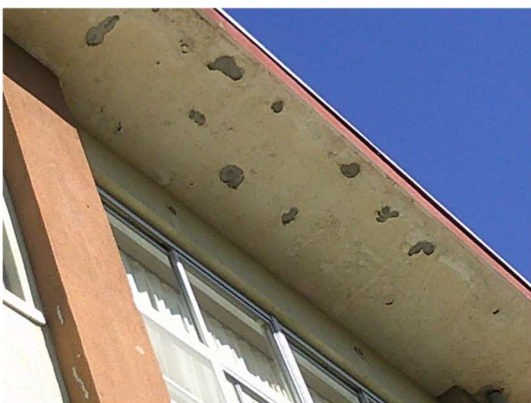
前原小 校舎-1(①-1棟) D評価 高所の剥離(下に昇降口があり、危険)
