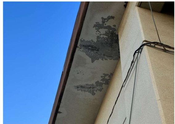
小金井第二中 体育館(㉓-1棟) D評価 軒天の塗装が剥落、露筋もみられる。
