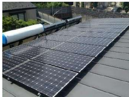
環境楽習館における太陽光パネル
