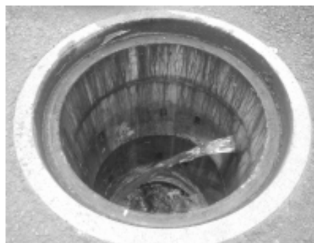
雨水浸透ます
