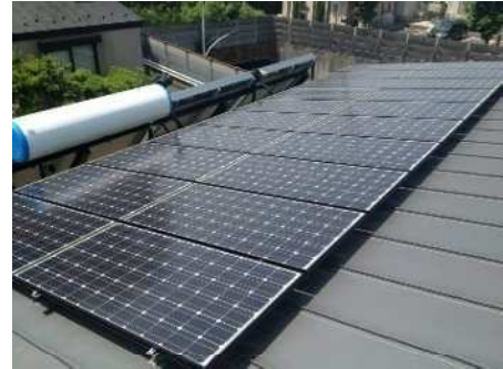
環境楽習館における太陽光パネル
