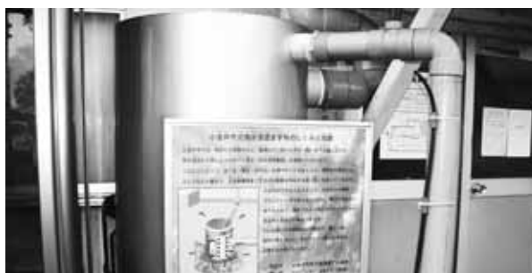
西庁舎前にある雨水浸透ます実験装置
