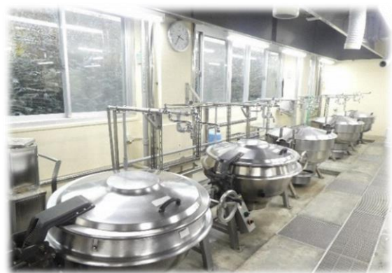
▲給食調理室の回転窯と空調設備
