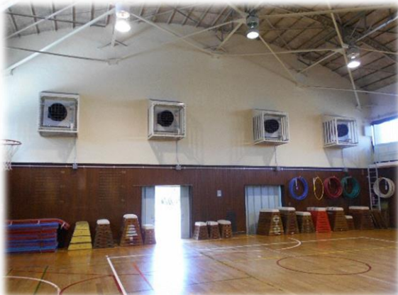
▲ 体育館の冷暖房設備
