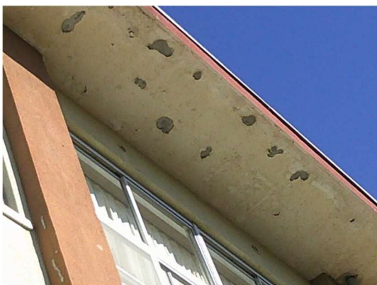
前原小 校舎-1(①-1棟) D評価 高所の剥離(下に昇降口があり、危険)
