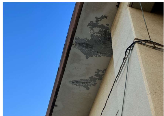
小金井第二中 体育館(⑳-1棟) D評価 軒天の塗装が剥落、露筋もみられる。
