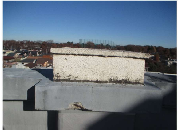
小金井第二小 校舎2・3(①-4棟) D評価 一部コンクリートが欠損。雨漏りも多数ある
