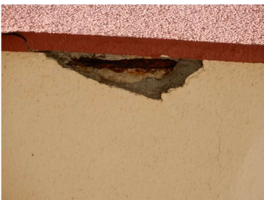
本町小 校舎2・体育館(⑬-1・2棟) D評価 非常階段の近くの軒下に露筋。
