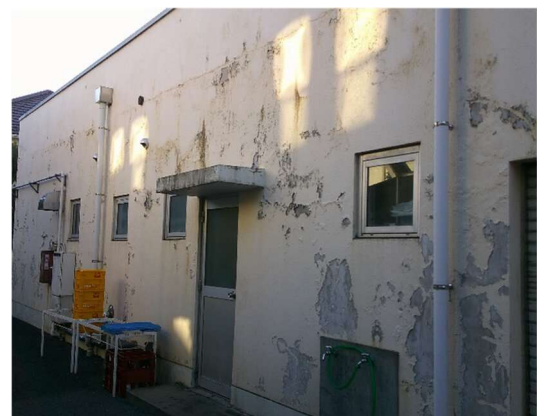
緑中 校舎1(①-1棟) D評価 給食室部分のモルタルの剥離が著しい。
