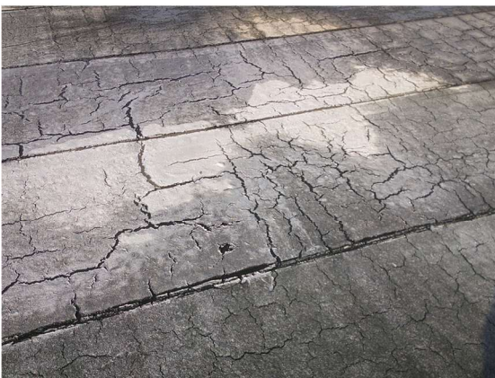
東小学校 校舎-3(⑳棟) C評価 露出防水が劣化している
