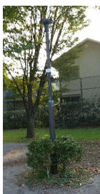
LED化した公園灯
